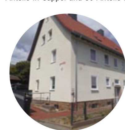
Zuschüsse vom Kreis gab es für die Sanierung des Genossenschafts-Hauses „Im Loh“ in Cölbe. (Foto: gwsbg)
